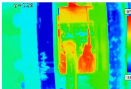
شکل ۱۰. تصویر حرارتی مکانیکال آب بند پمپ
