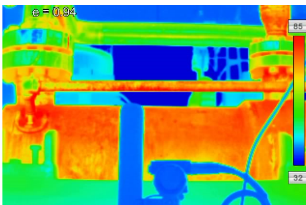
شکل ۱۸. تصویر حرارتی بدنه پمپ
