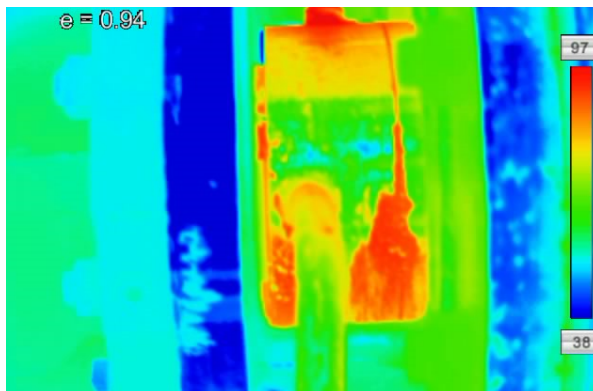
شکل ۱۶. تصویر حرارتی مکانیکال سیل DE پمپ
