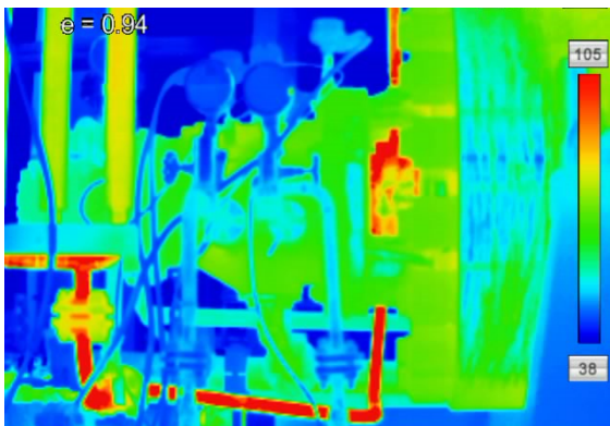
شکل ۱۷. تصویر حرارتی مکانیکال سیل NDE پمپ
