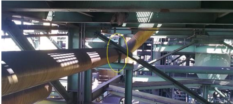
شکل ۲۱. خمیدگی ناودانی در اثر فشار خط و تماس با Bracing
