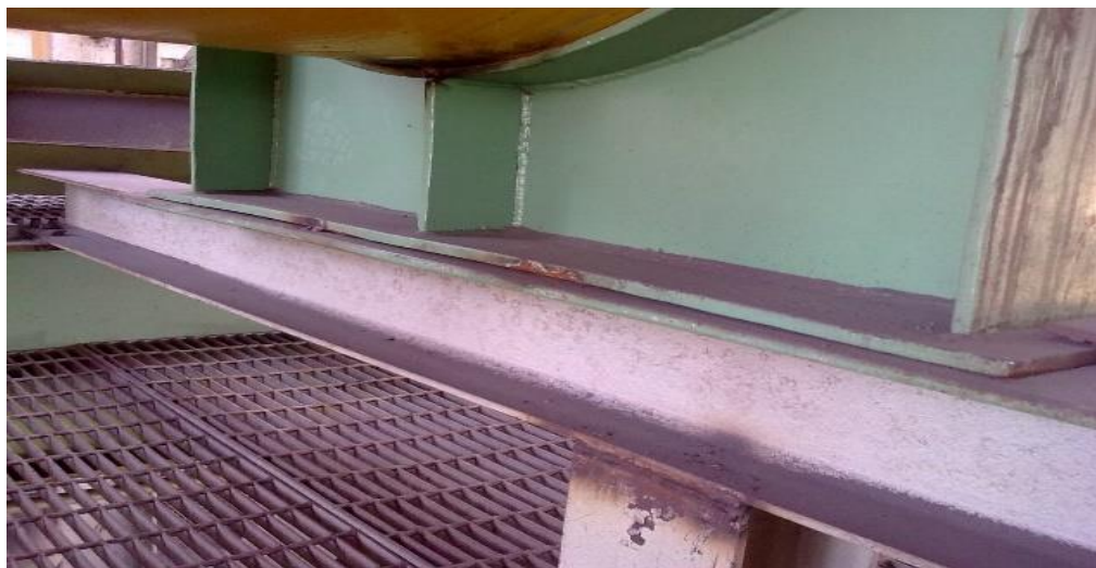
شکل ۱۶. وجود تک جوش از زمان ساخت
