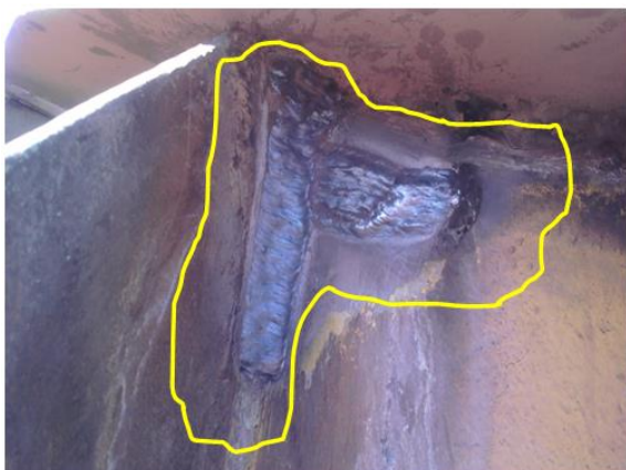
شکل ۱۱. شکستگی در محل اتصال لچکی‌های تکیه‌گاه
